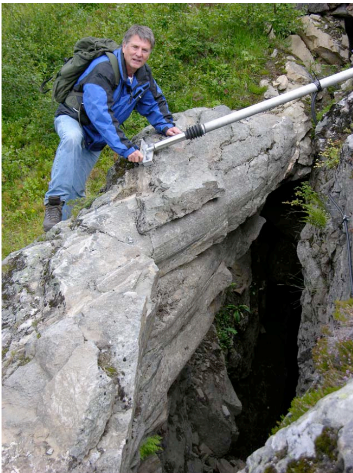
Figur 4: Installasjon av overvåkningssystem på Åknesremna
